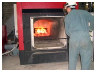
Maintenance de la chaufferie
