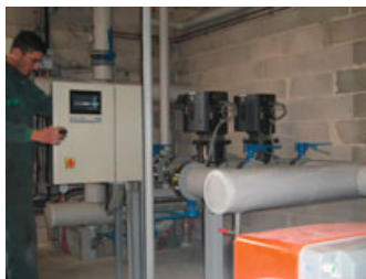
Maintenance de la chaufferie
