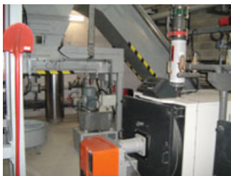
Maintenance de la chaufferie
