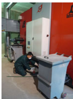
Maintenance de la chaufferie
