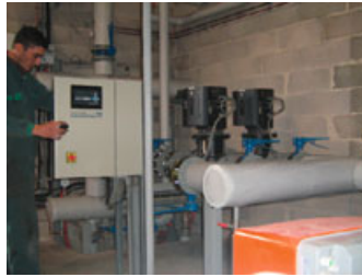
Maintenance de la chaufferie
