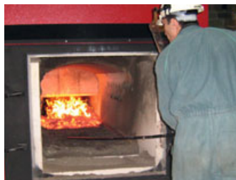
Maintenance de la chaufferie
