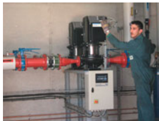
Maintenance de la chaufferie
