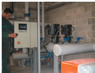
Maintenance de la chaufferie
