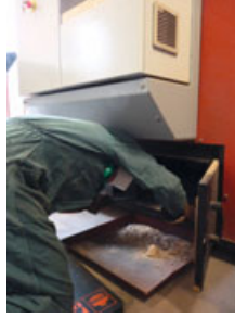
Maintenance de la chaufferie
